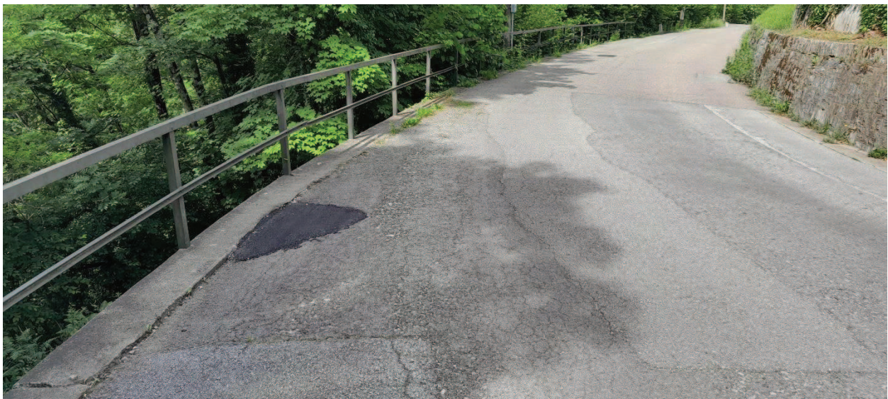
Figura 3 – Dettaglio cedimento parte di strada a monte
